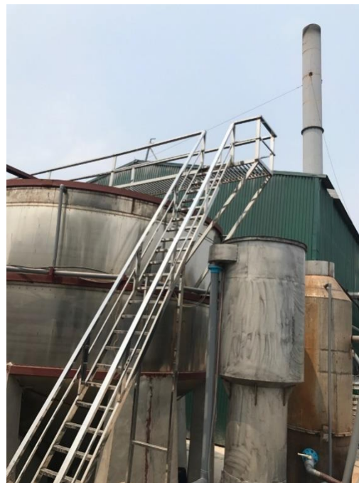
Hệ thống nồi hơi, tháp lắng vi sinh
