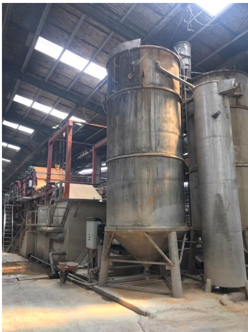
Tháp lắng bột
