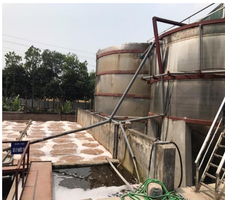
Hệ thống xử lý nước thải
